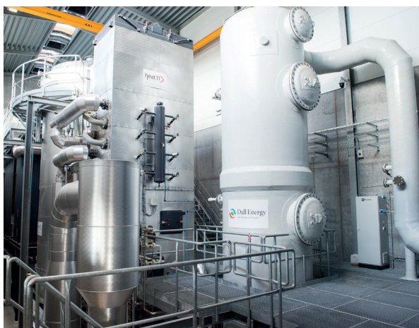
Dall Energy har leveret forgasningsovnen til det nye kraftvarmeværk.
